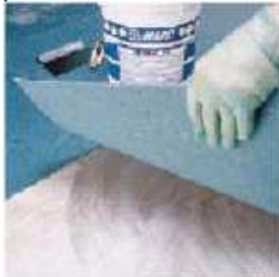
Монтаж плит гомогенного ПВХ выкладываемых с ADESILEX V4 , соединение двух смежных сторон
